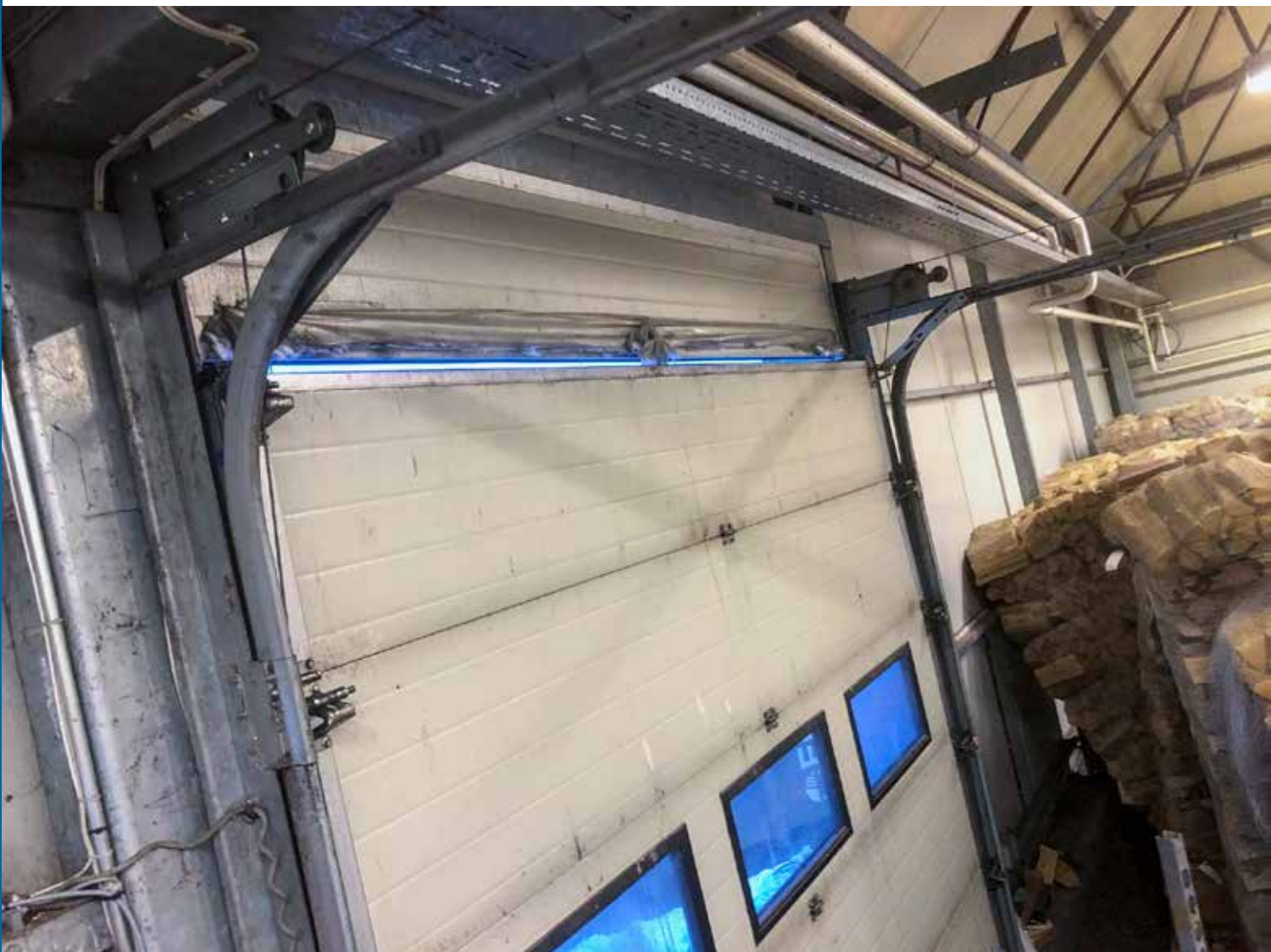
Vi fant flere steder med åpninger som fuglene brukte for å komme inn og ut av varehuset, som her på lageret i østre hjørne av bygget. Foto Bjørn Olav Tveit
